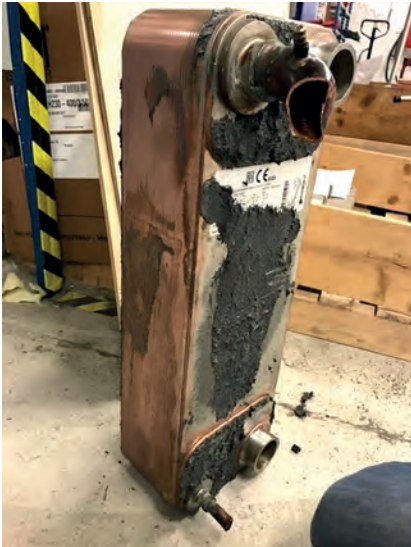
Bilde 5.4.01: Frostsprengt platevarmeveksler.
